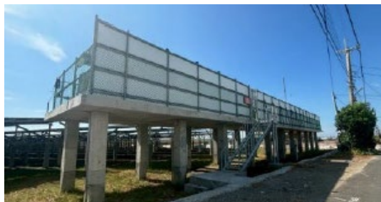
升壓站減噪措施
