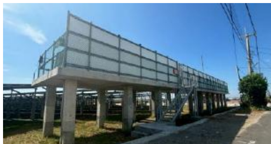
升壓站減噪措施
